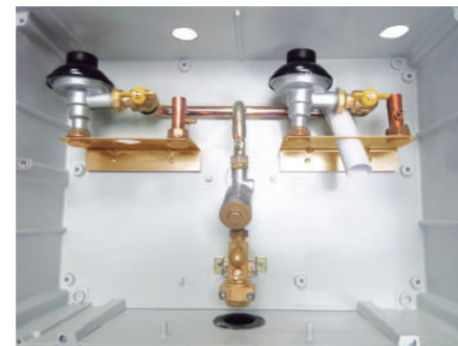
ARMARIO A-10, Caudal 10 m 3 /h, con seguridad mín. 2 Contador G-4
