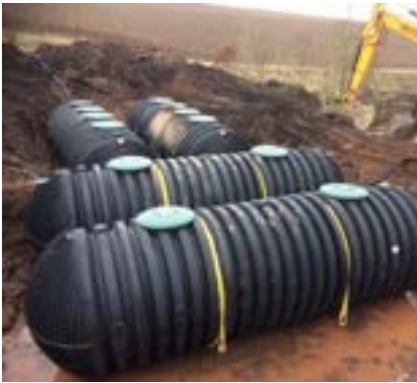
Depuradora fábrica de lácteos. oneAdvanced 350 HE
