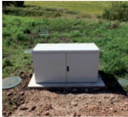
Depuradora fábrica de lácteos. oneAdvanced 350 HE
