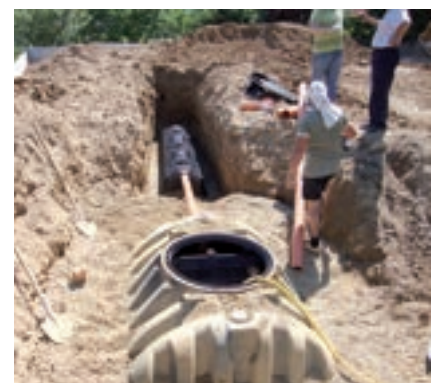
Depuradora con túneles de infiltración. 9HE
