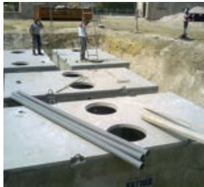
Depuradora hotel. Klaro 200 HE
