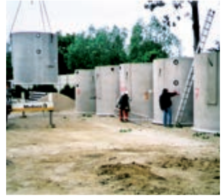
Depuradora hotel. Klaro 400 HE
