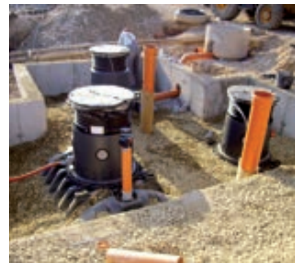
Depuradora en restaurante. oneAdvanced 40 HE
