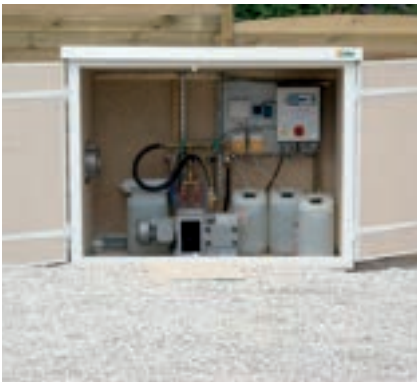
Depuradora hotel. Klaro 300 HE
