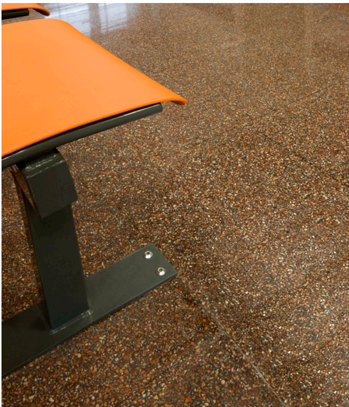
Centro penitenciario 3º Grado en SANTANDER. CANTABRIA. Pavimento interior de grano fino. Ref. 2010.
